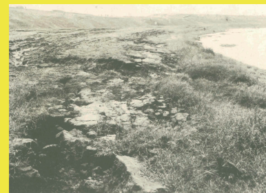
関東大震災による破堤
